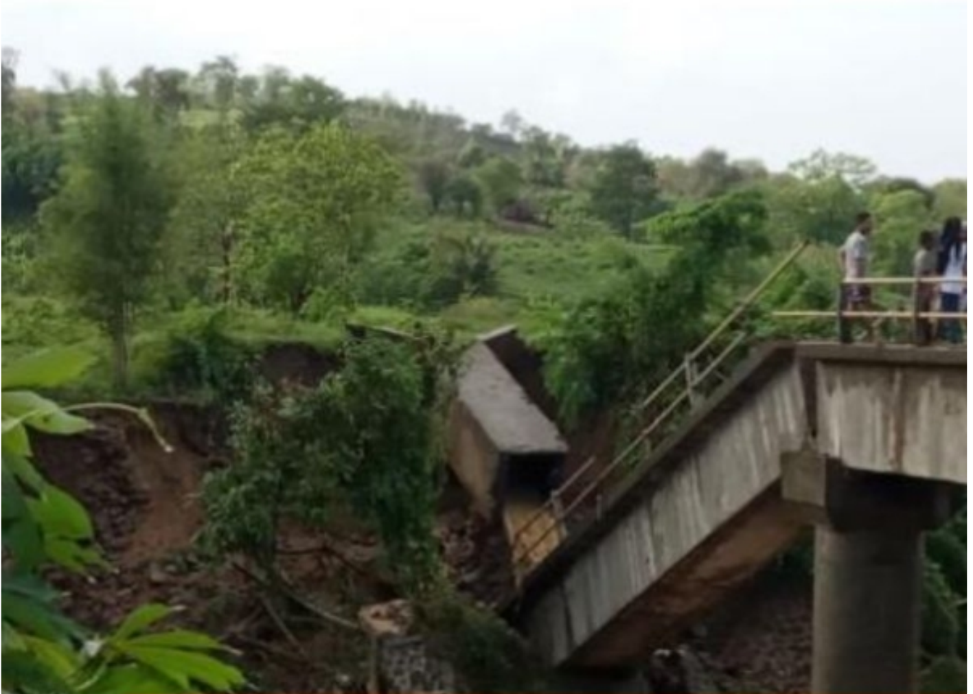
Jembatan Roboh akibat Banjir Bandeng di Lunyuk, Sumbawa, (09/10)
